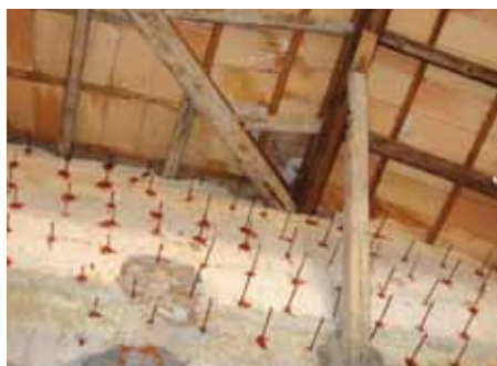
Inghisaggio delle barre ad aderenza migliorata nella muratura al fine di realizzare placcatura con betoncino armato
