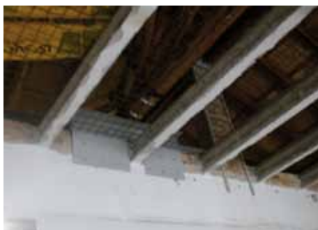
Confinamento dei solai pilastri del sottotetto tramite piastrine angolari. Aderenza dei mattoni all'acciaio realizzata inserendo negli interstizi resina HIT-MM Plus
